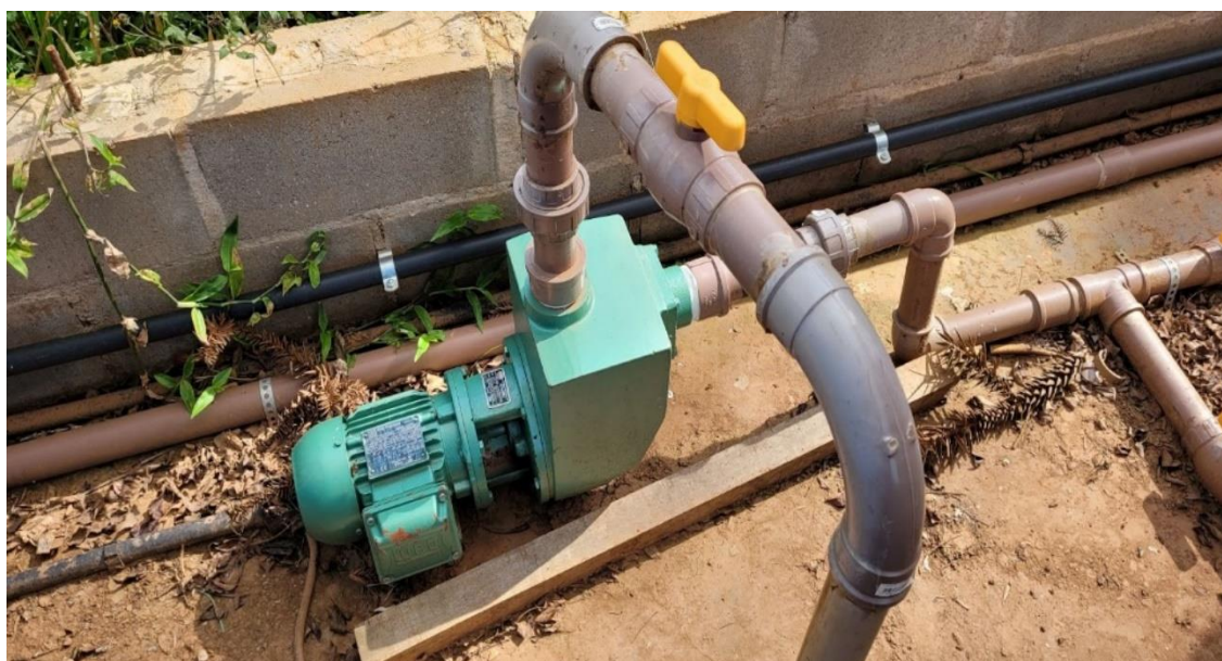
Figura 95: Bomba utilizada no bombeamento do lodo da estação.
