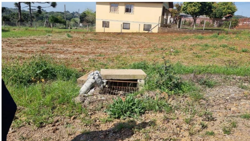
Figura 178: Drenagem urbana ineficiente.
