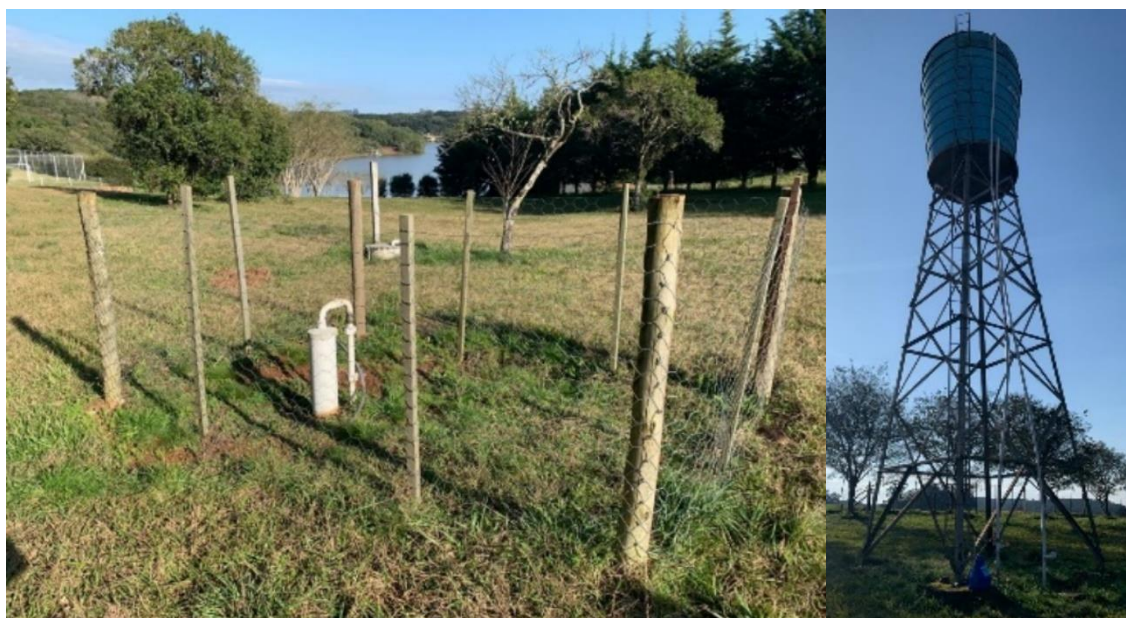
Figura 46: Poço, reservatório e tratamento Santo Antônio dos Gregolos (Country Bella Vista).
