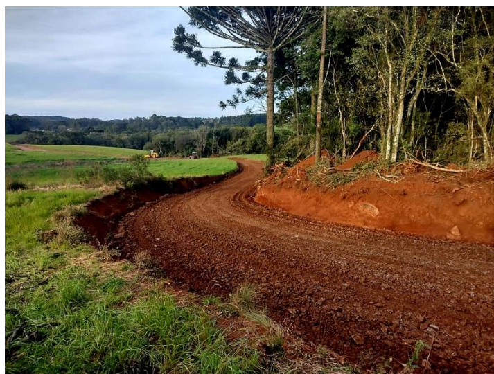
Figura 204: Drenagem pluvial na área rural.
