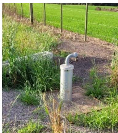
Figura 76: Poço inoperante Parque Industrial.
