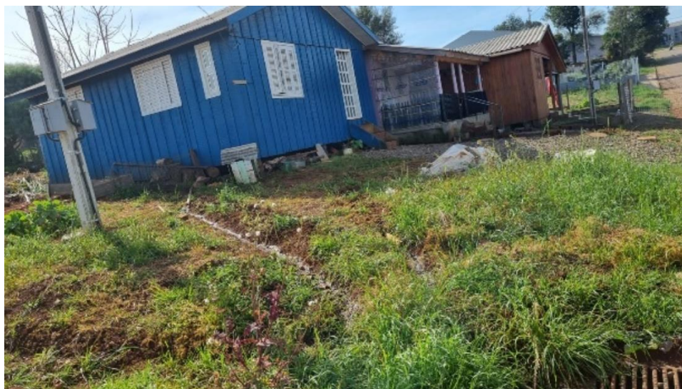
Figura 81: Efluente domiciliar disposto inadequadamente.
