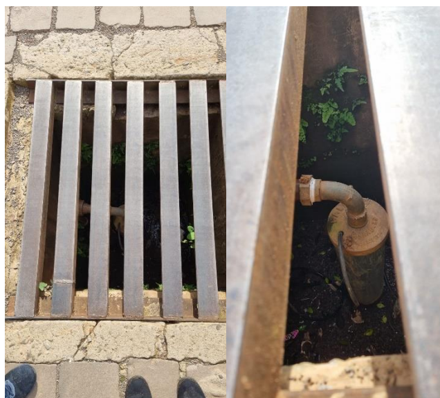
Figura 35: Poço do Centro, próximo a Escola Jorge Manfroi.
