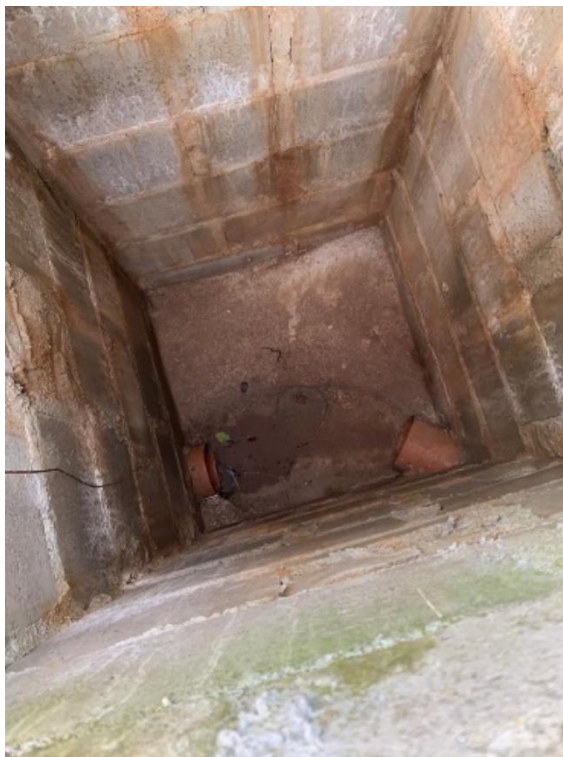
Figura 87: Fosso de direcionamento do esgoto para a ETE praticamente seco.
