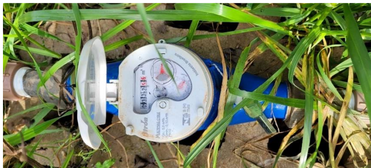
Figura 99: Hidrômetro na saída do efluente para o emissário final.
