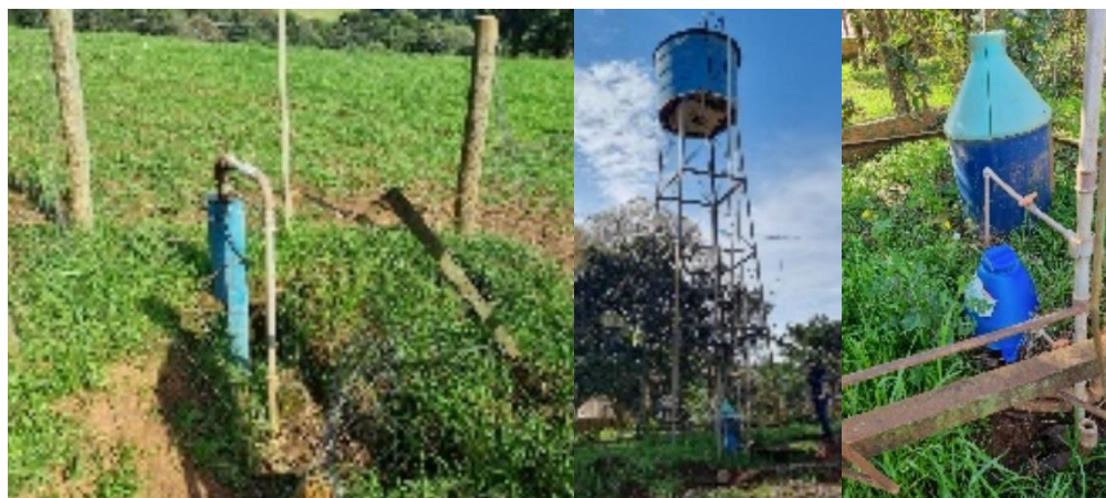
Figura 72: Poço, reservatório e tratamento Rincão dos Lopes (Lado do salão).
