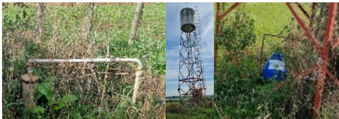
Figura 73: Poço, reservatório e tratamento Rincão dos Lopes (Propriedade Miguel Vibrantz).
