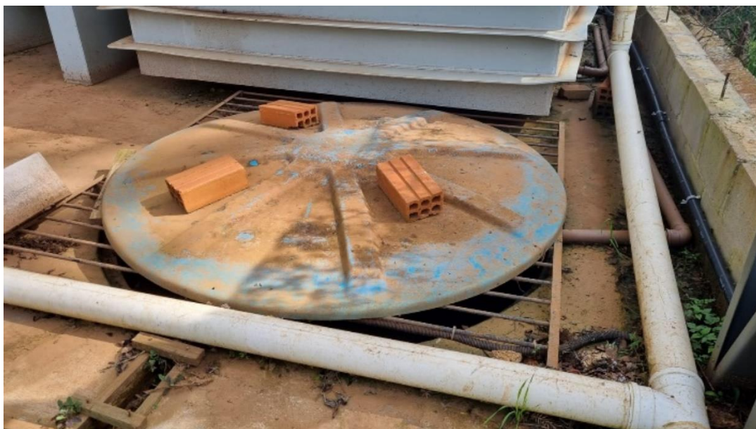
Figura 97: Tanque de retorno da estação de tratamento.
