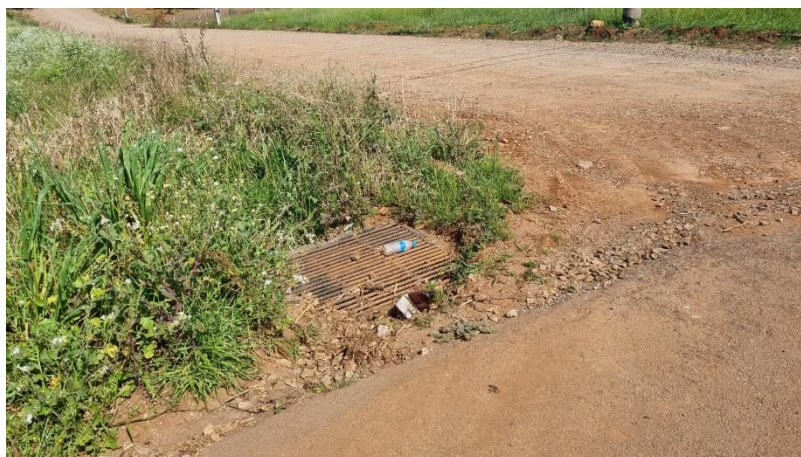
Figura 179: Drenagem urbana ineficiente.
