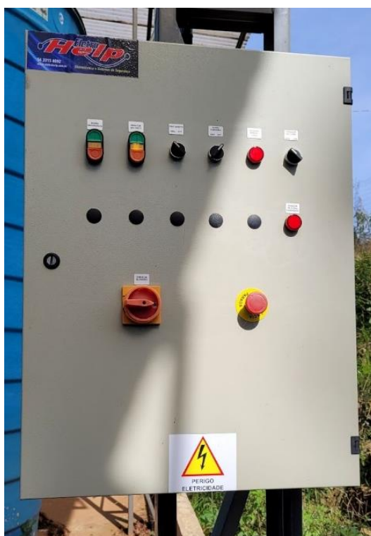
Figura 98: Painel de controle da ETE.
