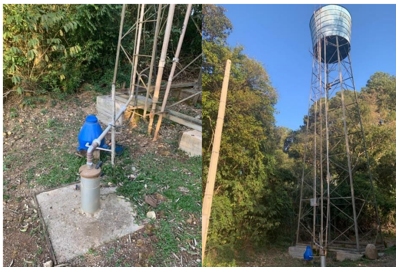
Figura 34: Poço, tratamento e reservatório Loteamento Loss.
