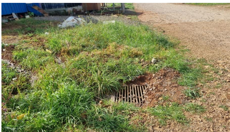
Figura 177: Drenagem urbana ineficiente.
