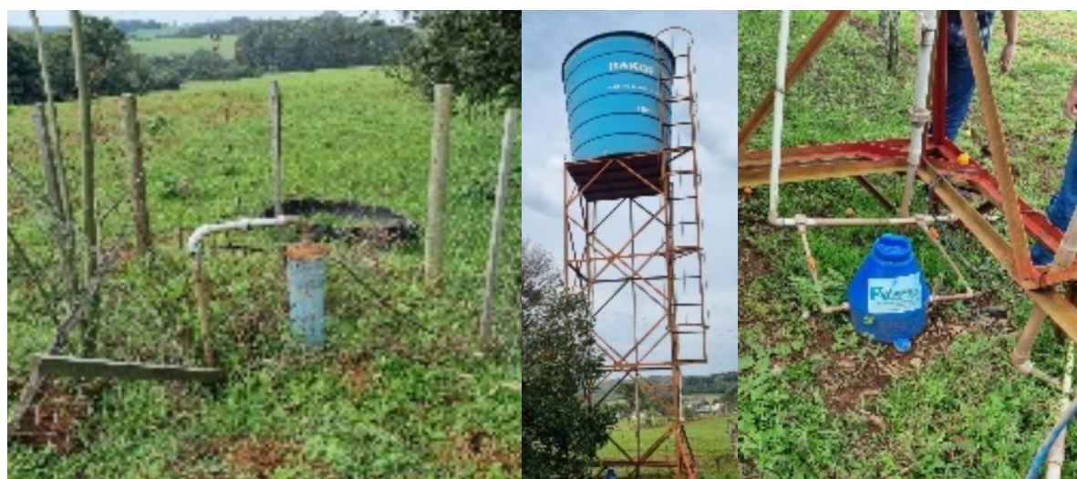
Figura 74: Poço, reservatório e tratamento Capão da Guarda (Vila Coelho).
