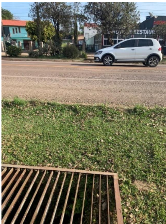
Figura 85: Poço de visita onde foi identificado o dano na tubulação de esgoto.
