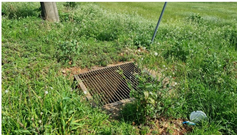
Figura 176: Drenagem urbana ineficiente.
