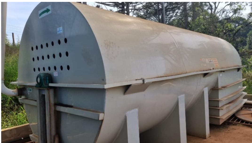
Figura 93: Biodisco da ETE de Mato Castelhana.
