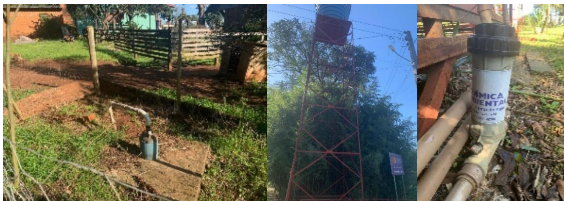
Figura 63: Poço, reservatório e tratamento Tijuco Preto (Propriedade Salvador Jeison).
