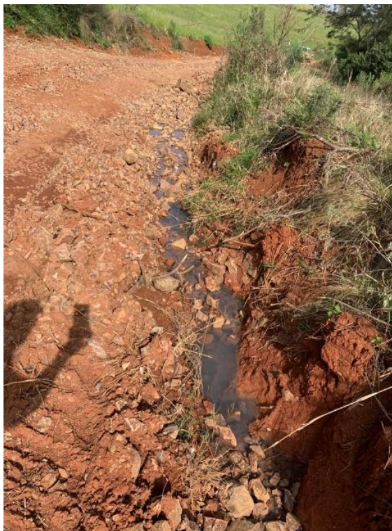
Figura 192: Água drenada com cor característica da presença de esgoto.
