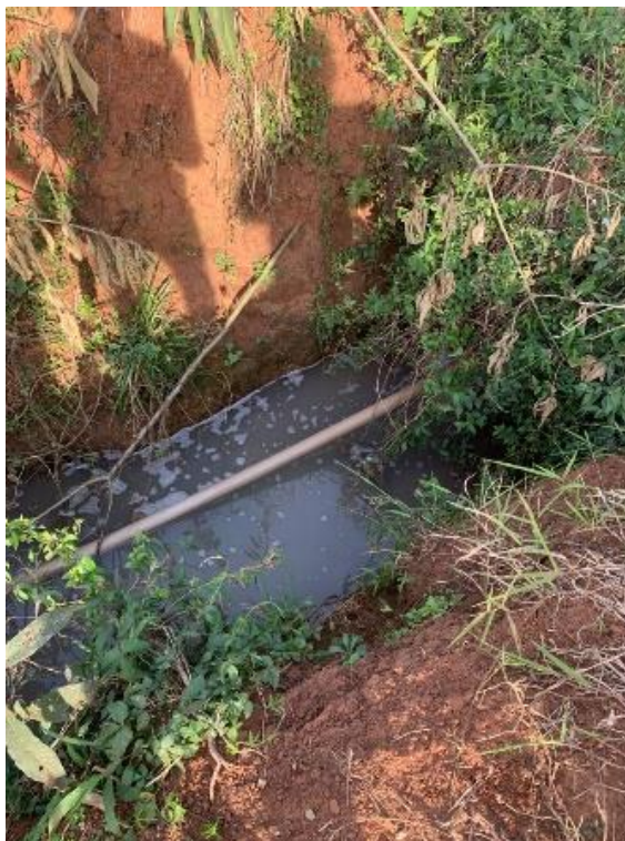
Figura 196: Terceiro ponto de deságue com grande quantidade de esgoto.
