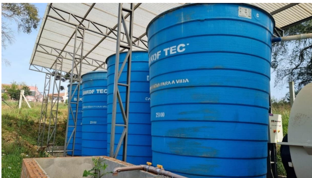
Figura 92: Equalizadores da ETE de Mato Castelhana.
