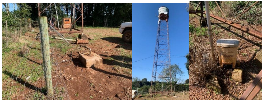
Figura 54: Poço, reservatório e tratamento Tijuco Preto (Próximo ao salão da comunidade).
