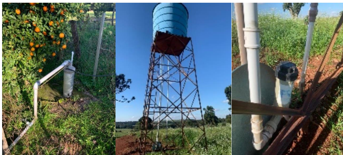
Figura 64: Poço e reservatório Tijuco Preto (Propriedade Saul).
