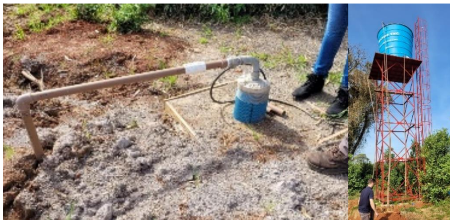
Figura 75: Poço e reservatório inoperante Nossa Senhora de Lourdes (Propriedade David Rossato).
