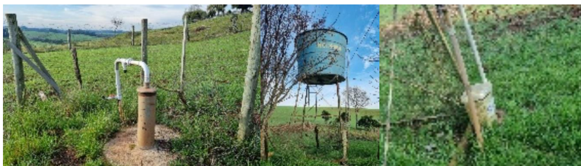
Figura 70: Poço, reservatório e tratamento Rio do Peixe (Propriedade Luis Anacleto).
