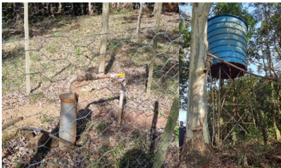
Figura 51: Poço e reservatório Capinguí (Chácara do Sato).
