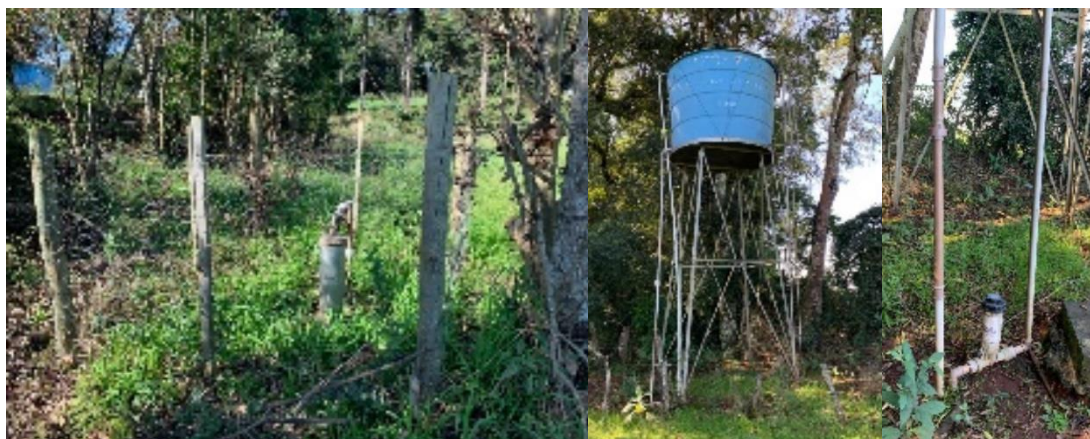
Figura 53: Poço, reservatório e tratamento Tijuco Preto (Propriedade Maria Helena).
