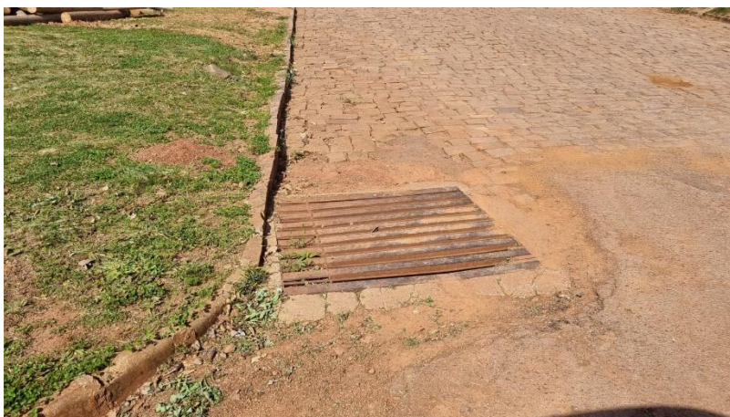
Figura 174: Boca-de-lobo com grelha.
