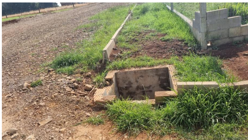
Figura 188: Boca-de-lobo sem tampa.
