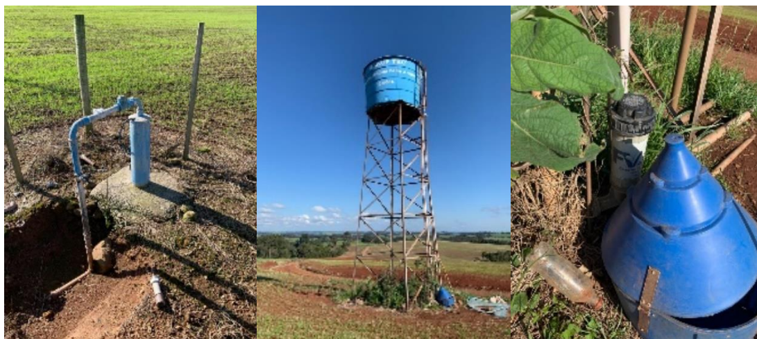
Figura 59: Poço, reservatório e tratamento Nova Linha São Roque.
