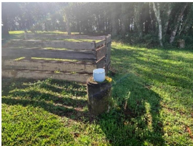
Figura 47: Poço Capinguí Consoladora desativado.
