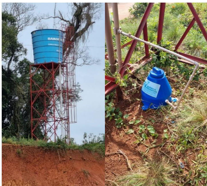
Figura 39: Reservatório e tratamento no Centro, próximo à Praça Jery A. Picolli.
