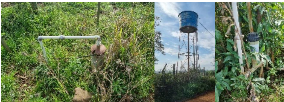
Figura 71: Poço, reservatório e tratamento Rincão dos Lopes (Propriedade do Suco).
