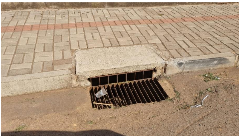
Figura 186: Presença de resíduos sólidos na boca-de-lobo.
