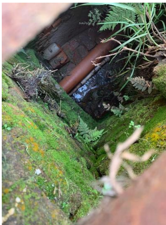
Figura 198: Tubulação de esgoto danificada.
