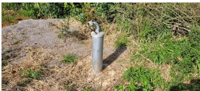
Figura 43: Poço Parque de Rodeios inoperante.
