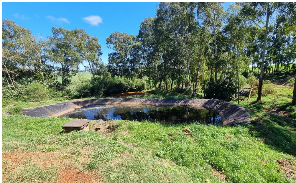
Figura 144: Lagoas de tratamento do lixiviado e lagoas de água pluvial.
