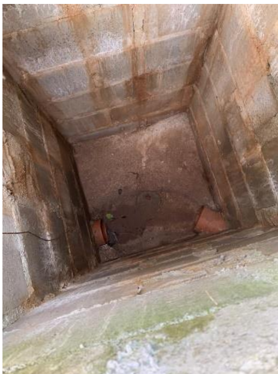
Figura 199: Fosso de direcionamento do esgoto para a ETE praticamente seco.
