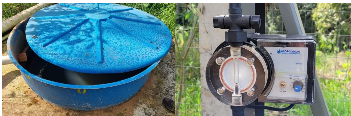
Figura 96: Tanque de cloração e bomba dosadora de cloro.
