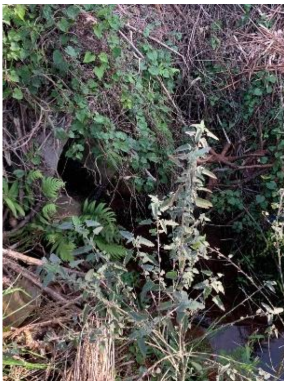
Figura 200: Quarto ponto de deságue das águas pluviais.
