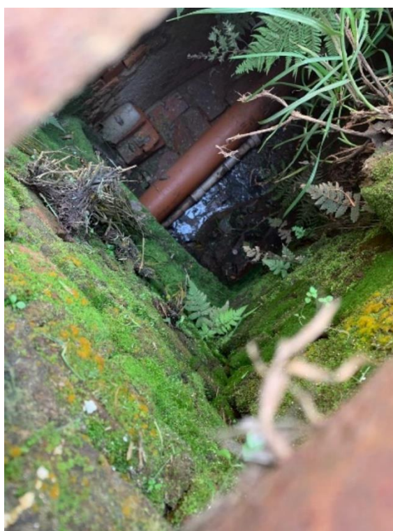
Figura 86: Tubulação de esgoto danificada.
