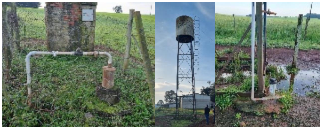
Figura 68: Poço, reservatório e tratamento Butiazinho (Propriedade Aristides Fontoura).
