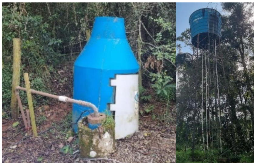
Figura 40: Poço e reservatório do centro, próximo ao Nervo Blocos.
