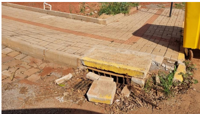
Figura 189: Boca-de-lobo com resíduos e rochas afetando o escoamento.
