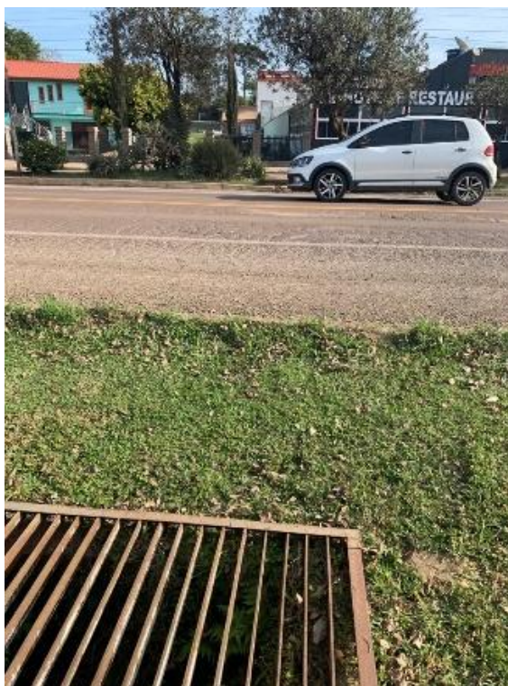
Figura 197: Poço de visita onde foi identificado o dano na tubulação de esgoto.
