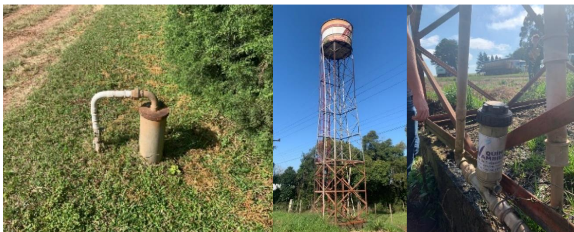
Figura 52: Poço, reservatório e tratamento Povinho Velho (Vieira - BR 285).
